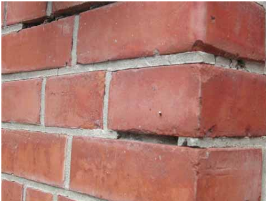
磚牆灰縫風化及受外力損壞集中在右前側牆體
