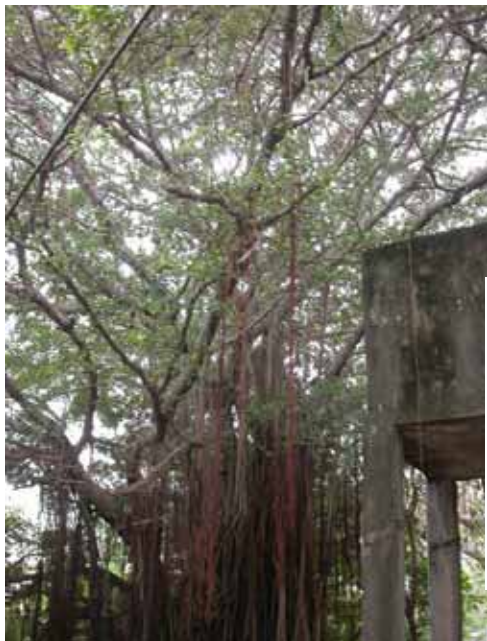
榕樹鬚根蔓生繁衍其根部已經深入武德殿基礎而產生破壞，未來將出現樹木保育與古蹟保存之間的衝突，樹木移植到適當地點似乎是在所必行的方式。
